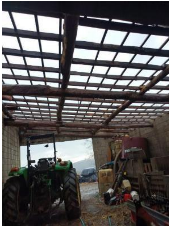
Figura 4. Cobertura de edificação, destruída após passagem do tornado ocorrido no dia 07.04.2026, Fresulfe - Vinhais Foto por: Anabela Coimbra
